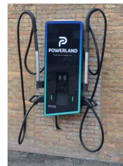
Direct gebruik van DC stroom via een DC oplaadpunt
